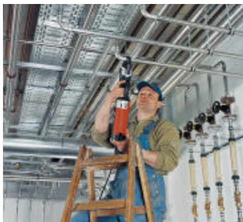
Insgesamt 12.900 lfm Edelstahlrohre (DN 15-150, Werkstoff-Nr. 1.4401) wurden in der Unfall- klinik Murnau verbaut.
