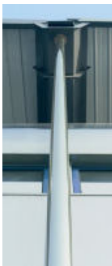
Tuyaux de descente en acier inoxydable recuit brillant sur un centre de services acier à Gavá, Espagne
