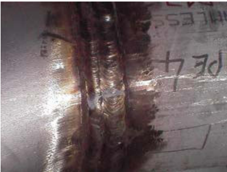
Unbehandelte Schweißverbindung: Die Zunderschicht kann Ausgangspunkt von Korrosion werden, wenn sie nicht sachgemäß entfernt wird.
