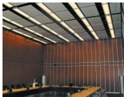
In dem internationalen Konferenzzentrum in Genf wurden ca. 260 m 2 „strahlende Flächen“ als Bestandteile der abgehängten Decken verbaut.
