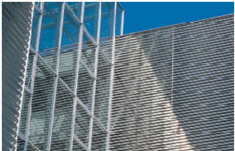
Il rivestimento di acciaio inossidabile si riflette nella vetrata, ed a sua volta il vetro crea effetti di luce piacevoli sulla lamiera ondulata.
