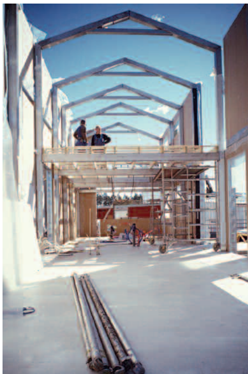
Auf der Grundlage einer expliziten Bauablaufplanung lassen sich Konstruktionen aus nichtrostendem Stahl ergebnisreicher und schnell erstellen.
